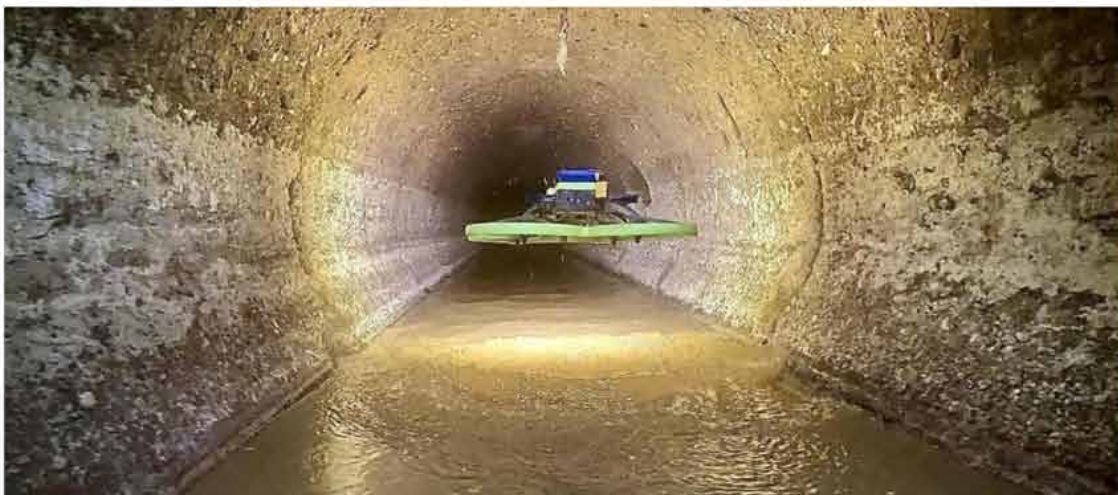
El dron de Aguas de Cádiz, en el alcantarillado Aguas de Cádiz
